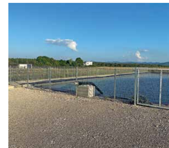
Löschwasserentnahme durch eine Steigleitung.
