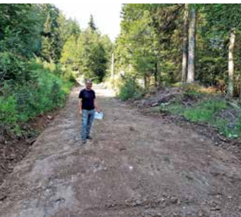
Unzureichende Wasserhaltung führte zur Aus- schwemmung der Fahrbahn. Mit dem Böschungslöffel abgezogene Fahrbahn. Bergwärts wurde der Spitzgraben nachgezogen.
