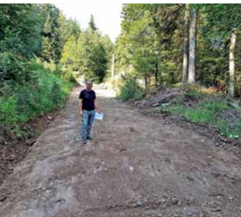
Unzureichende Wasserhaltung führte zur Ausschwemmung der Fahrbahn. Mit dem Böschungslöffel abgezogene Fahrbahn. Bergseits wurde der Spitzgraben nachgezogen.
