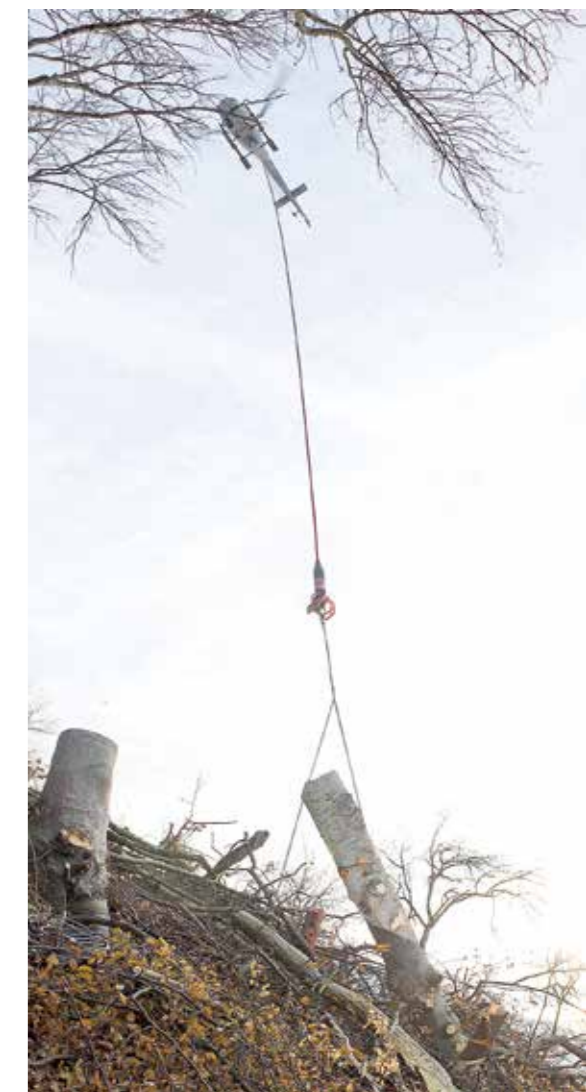
Idealerweise sollte eine Holzfuhr in etwa 90 % der maximalen Traglast des eingesetzten Helikopters betragen.
